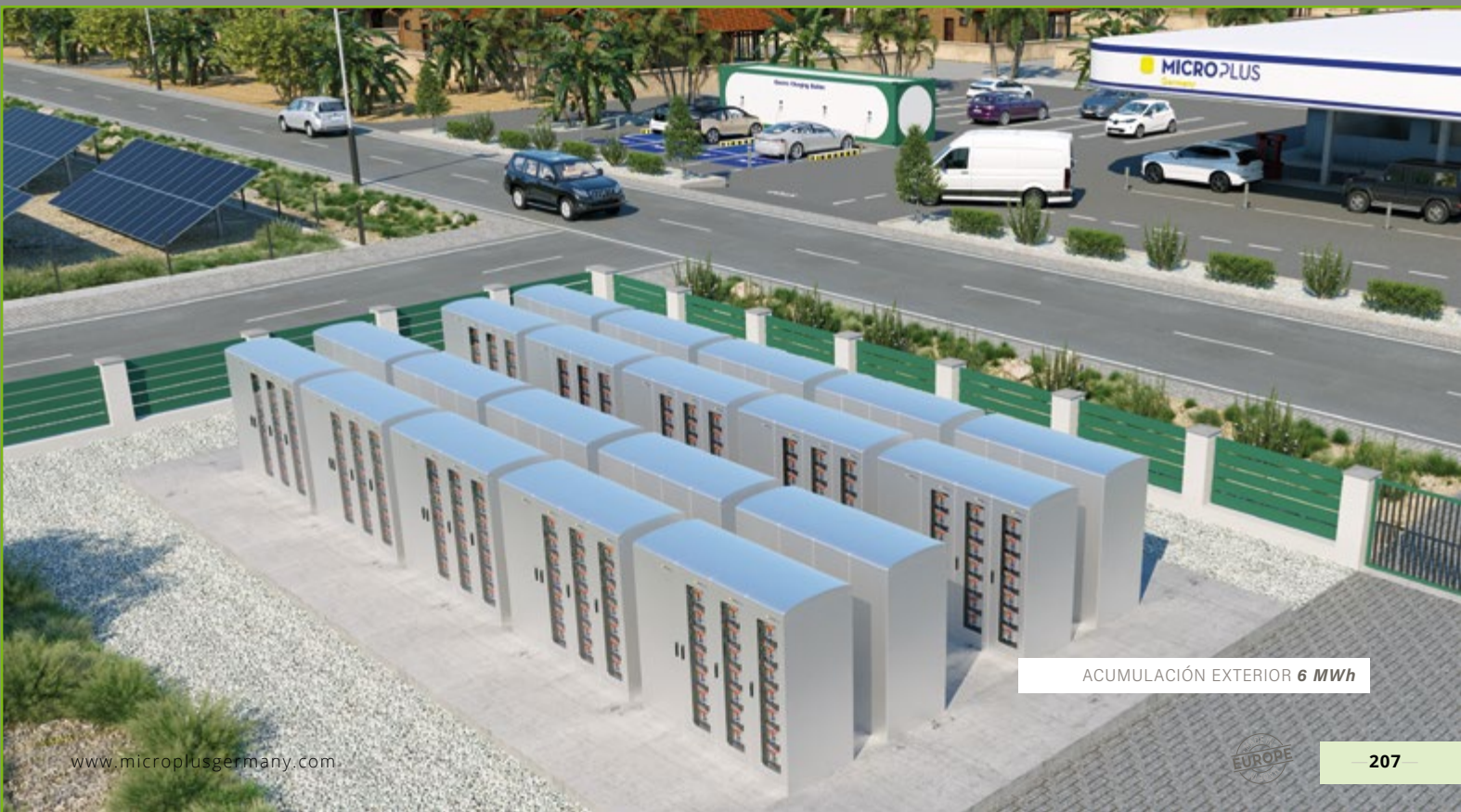
ACUMULACIÓN EXTERIOR 3 MWh
